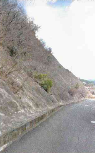
落石が多発する蔵王町崖地の改修が実現。
